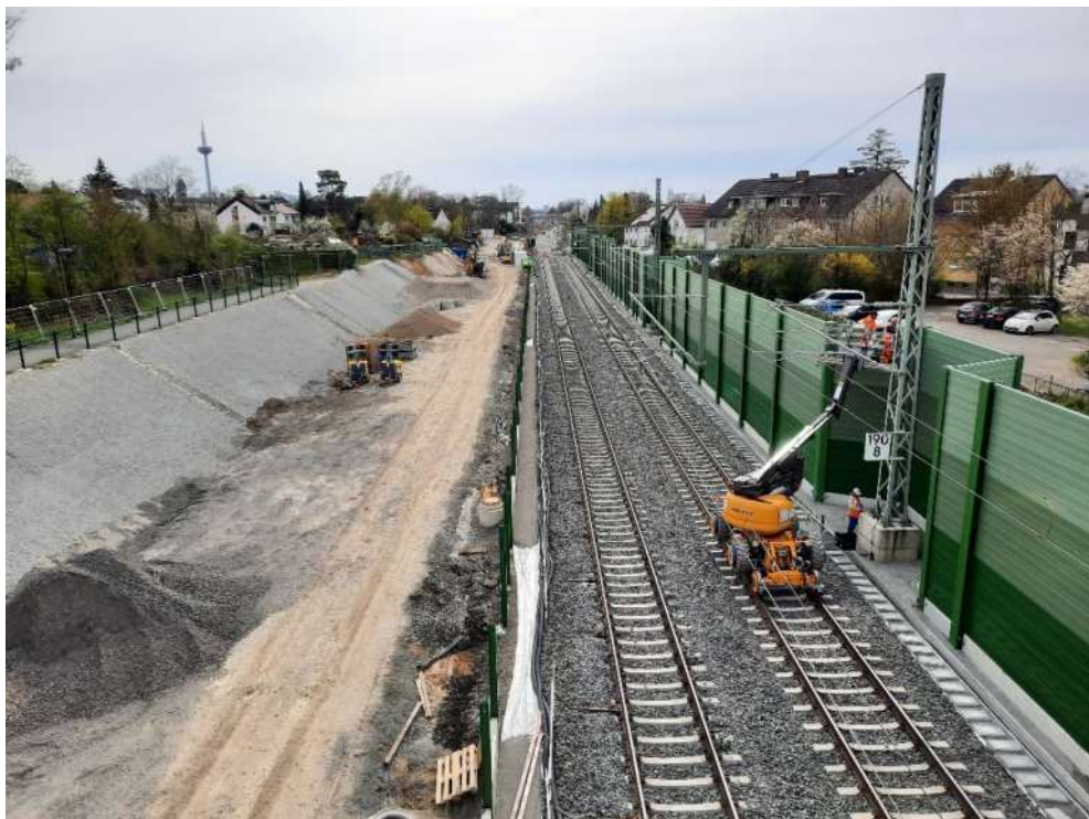
Die Main-Weser-Bahn am Ostermontag 2023 im Moment der Bauarbeiten mit Sperrpause, Blick von der Brücke "Am grünen Graben" in Frankfurt-Eschersheim. (Foto: Thomas Kraft)
